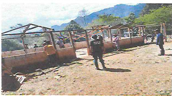
Foto 1: se observa la destruccion del edificio escolar para hacer su mantenimiento previo a la remozamiento
